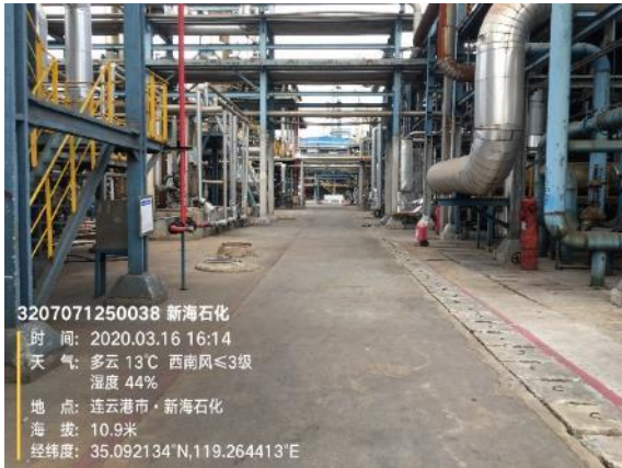
污水或污油地下输送管线
