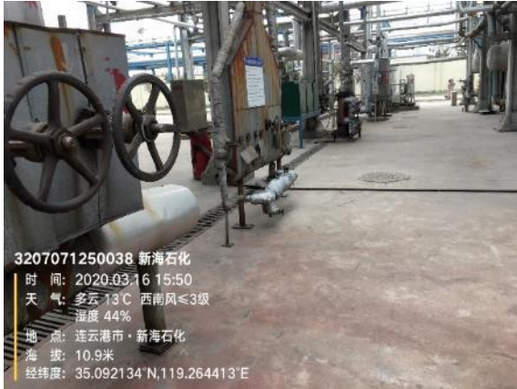
污水或污油地下输送管线
