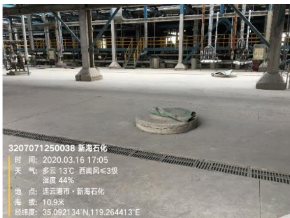
污水或污油地下输送管线
