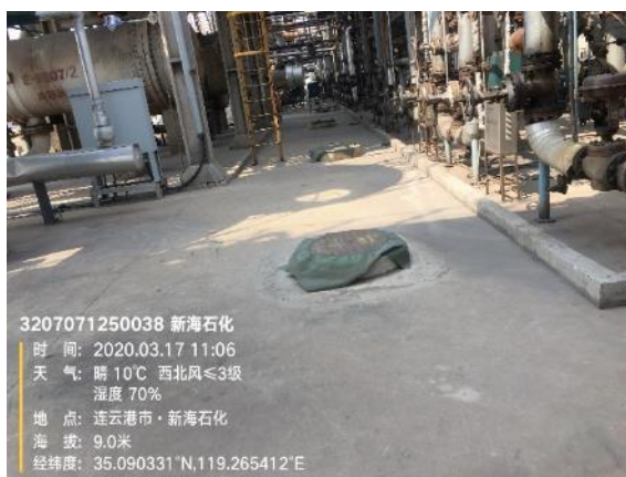
污水或污油地下输送管线
