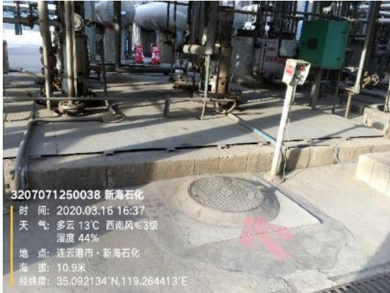
污水或污油地下输送管线
