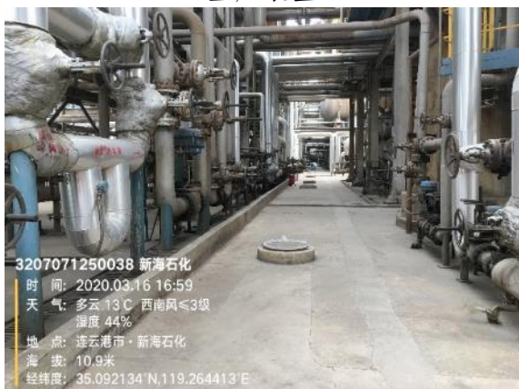
污水或污油地下输送管线
