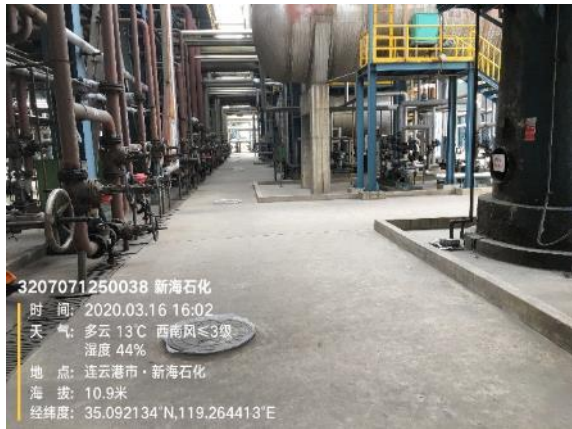
污水或污油地下输送管线
